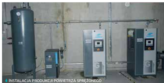
INSTALACJA PRODUKCJI POWIETRZA SPRĘŻONEGO
