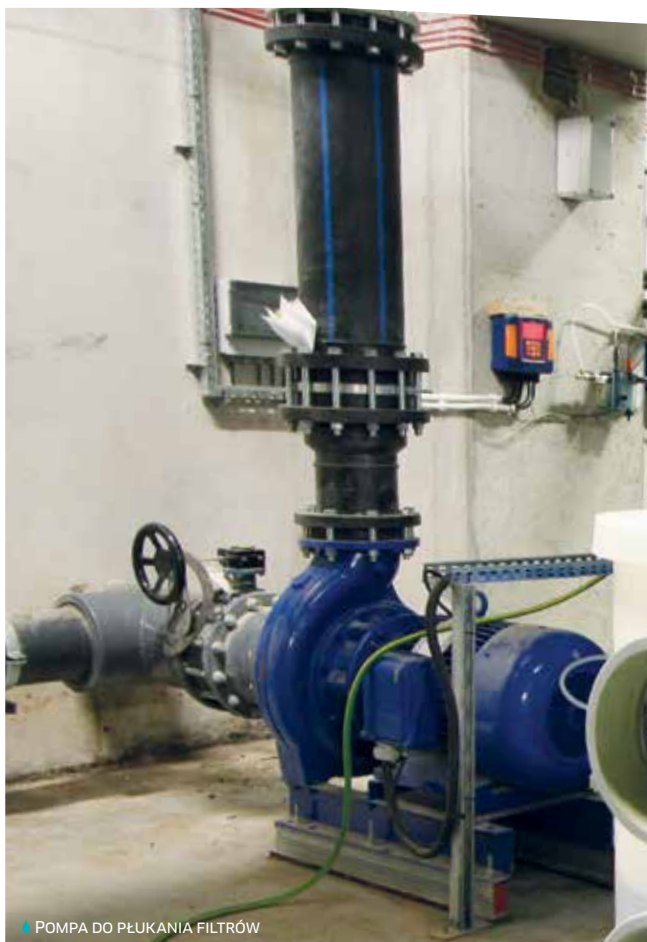
POMPA DO PŁUKANIA FILTRÓW
