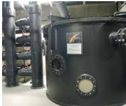
◆ WIDOK NA FILTR BIOLOGICZNY I LAMPY UV W AKWARIUM MORZE CZERWONE
