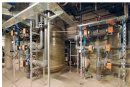
◆ INSTALACJE PRACUJĄCE W PEŁNEJ AUTOMATYCE
