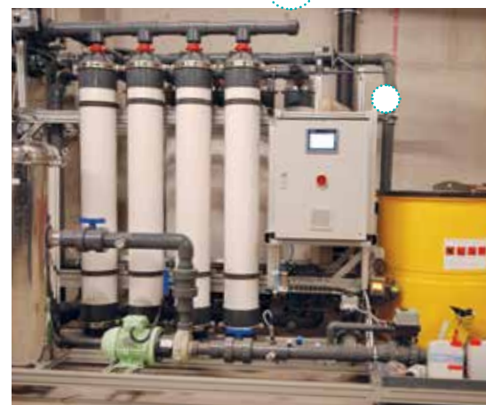
◆ INSTALACJA MIKROFILTRACJI DO ODZYSKIWIANIA WODY Z POPŁUCZYN FILTRACYJNYCH
